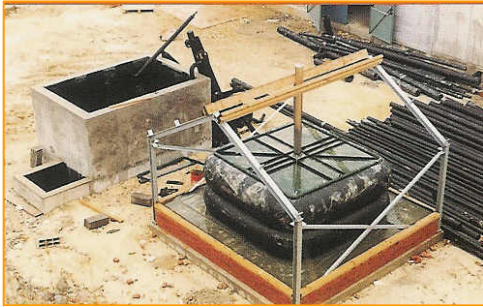
Figuur: externe trapezium biogasopslag
