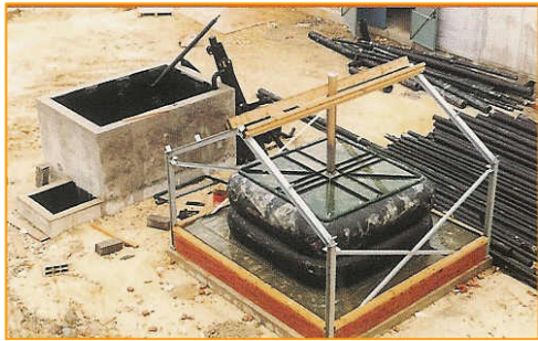
Figuur: externe trapezium biogasopslag
