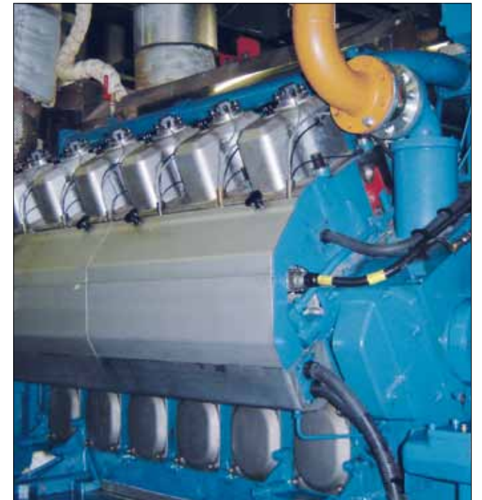
Een van de gasmotoren 2,15 MWe in het UMC Utrecht
