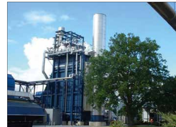
Warmtekrachtcentrale met op de voorgrond de eikenboom Bron: Emmtec Services
