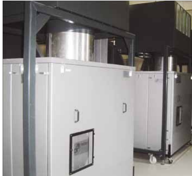
Geluidsdempers bij de inlaat van de ketels
