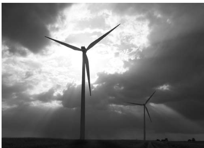
Zagórze wind farm @PWEA
